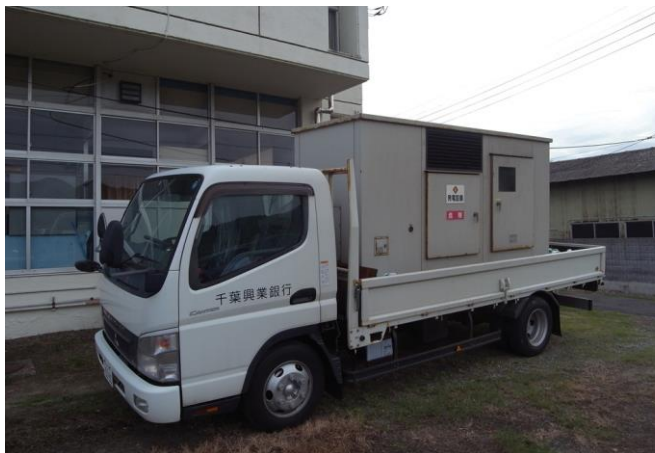
【電源車による電気供給】
